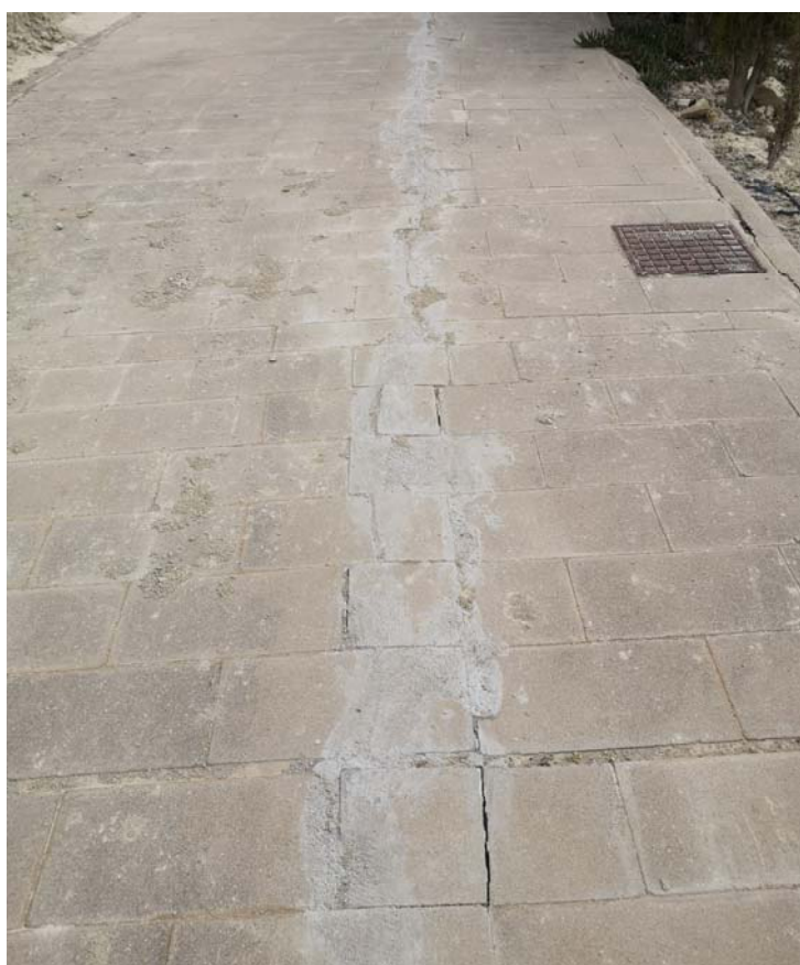
Fot. 10- Grietas de más de 2mm de espesor en camino pavimentado.
